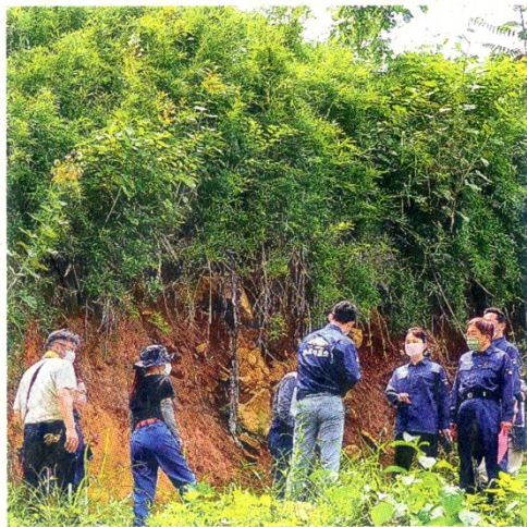
崩落地を視察する県議ら＝函南町田代
